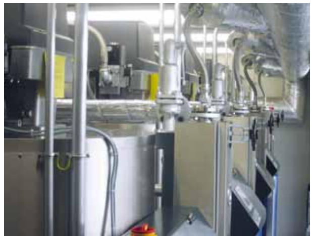
Ilustracja: kotłownia kontenerowa
