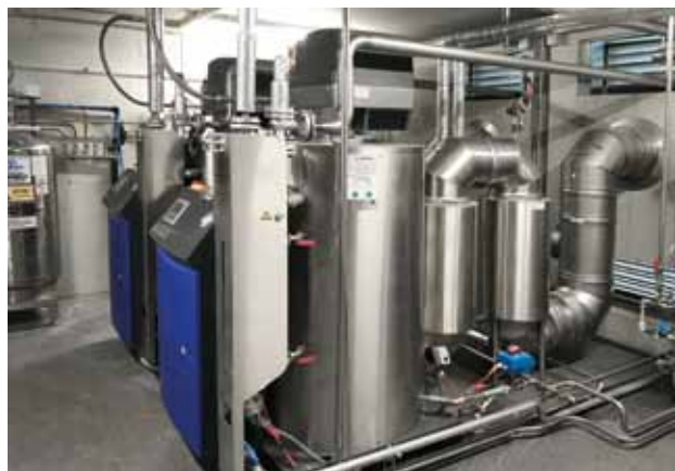
Ilustracja: Stacja wielowytwornicowa. Dla oszczędności miejsca dodatkowy ekonomizer zamontowano na platformie.
