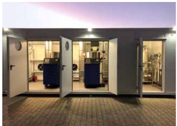
Ilustracja: kotłownia kontenerowa
